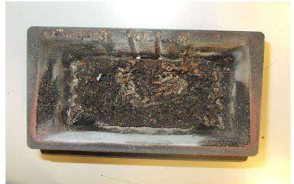
BEISPIEL VERSCHMUTZTE BRENNSCHALE
